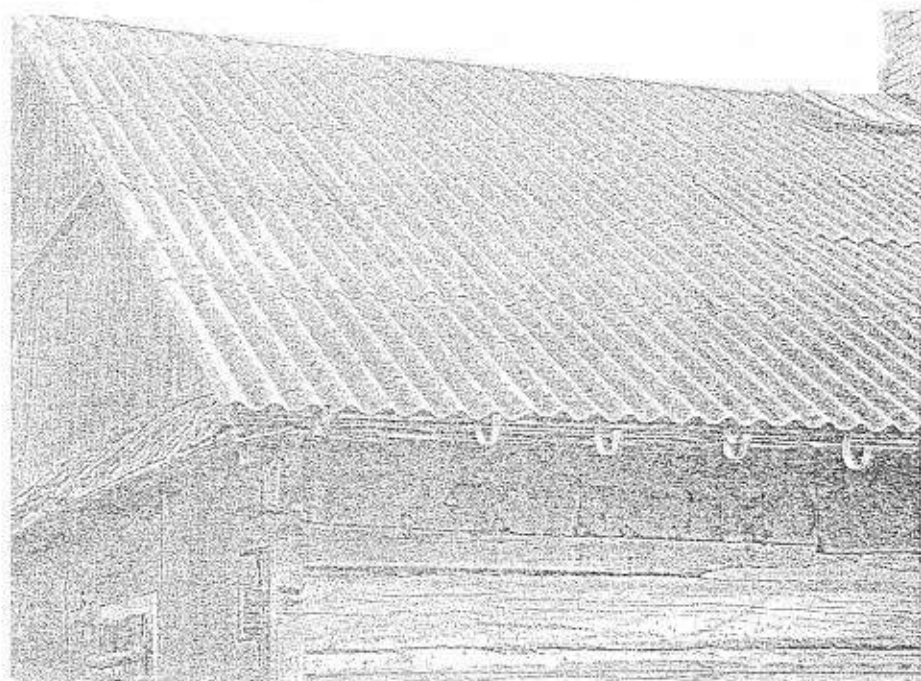
Podczas inwentaryzacji w 2006 r. w gminie Końskowola oszacowano ilość płyt azbestowo-cementowych: płyty faliste - 442453 m 2 , płyty płaskie - 44424 m 2 . fot. K. Kozak
